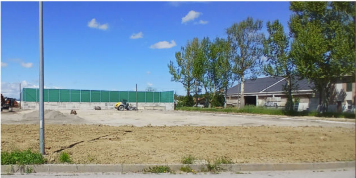
Figura 9: Barriera fonoassorbente – lato sud-est dello stabilimento
